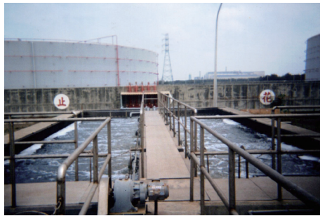
台中火力發電廠污水處理廠
